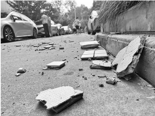
小区楼体外立面掉落的瓷砖
