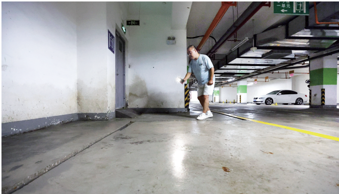
地下车库长期渗水,开的引水槽。
