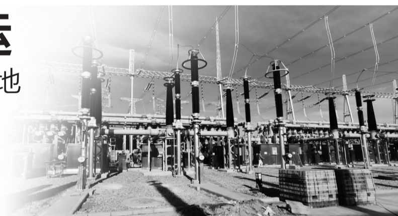
330千伏泾河变电站工程建设中。刘子豪摄
