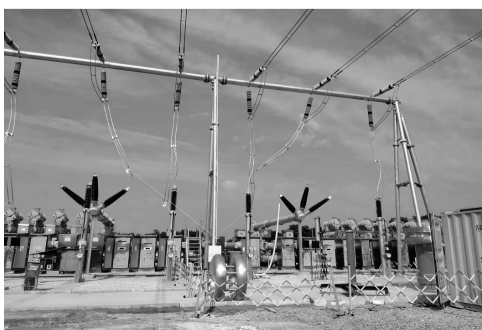
330千伏泾河变电站工程进行高压试验。刘子豪摄
