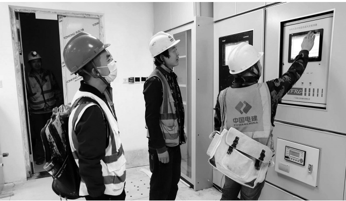
地铁15号线相关设备已经启动调试。
