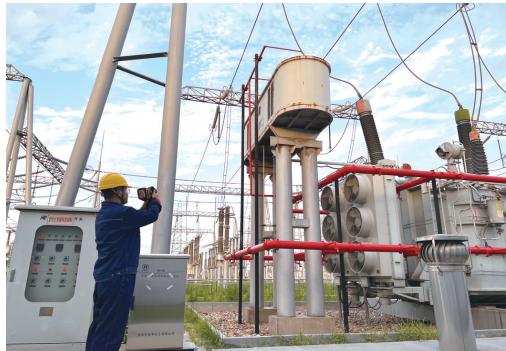
国网陕西电力员工进行设备巡视。
