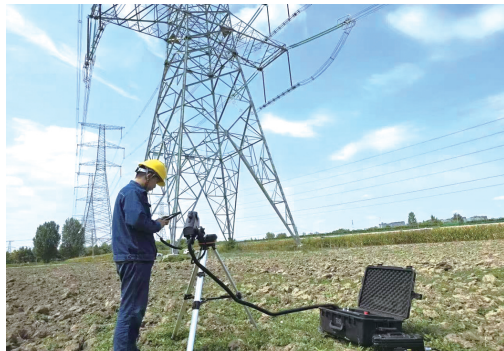
国网陕西电力员工进行设备巡视。
