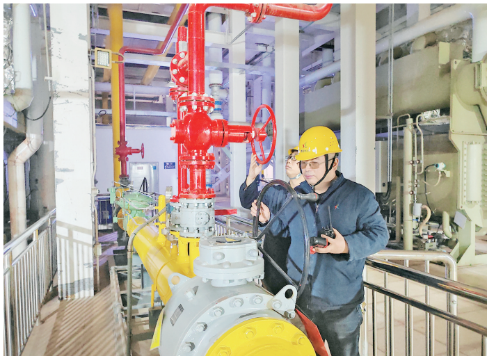
供热企业巡检人员检查设备运行情况。 本报记者 文晨 摄
