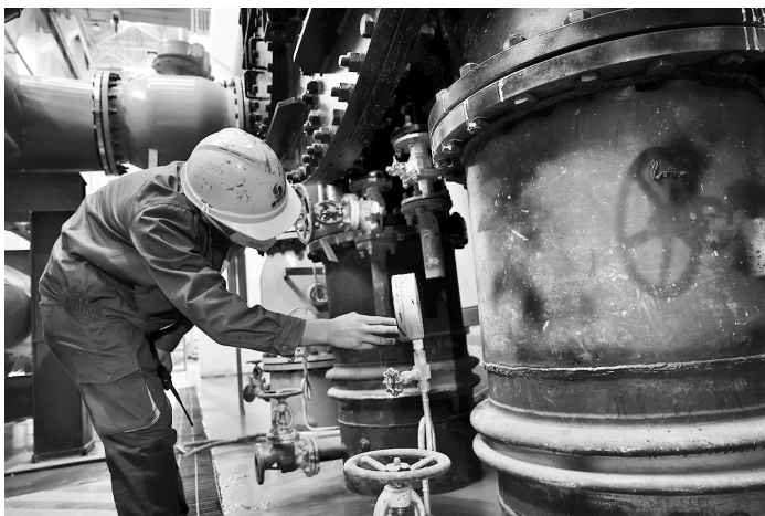
西安泾渭康恒环境能源有限公司工作人员在检查供热设备。
