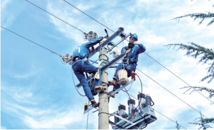
国网陕西电力员工对配网线路进行检查。
