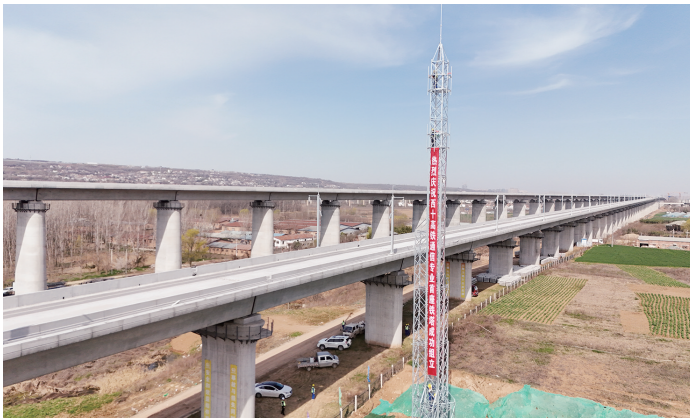
西十高铁全线首座通信铁塔。
