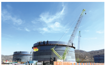
延长石油延安天然气储气调峰及配套LNG项目基地。
