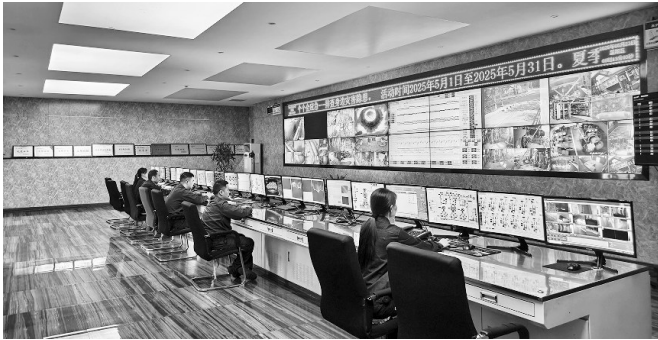
龙钢公司5#高炉主控室。
