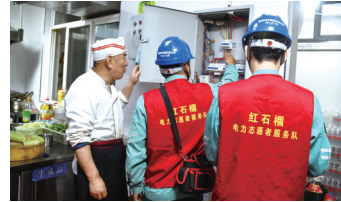
临潼区供电公司(红石榴)电力志愿者深入古槐养老院检查厨房用电,消除安全隐患。
