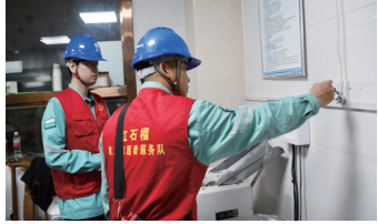
临潼区供电公司(红石榴)电力志愿者在古槐养老院测量插座负荷,为养老院安全用电保驾护航。
