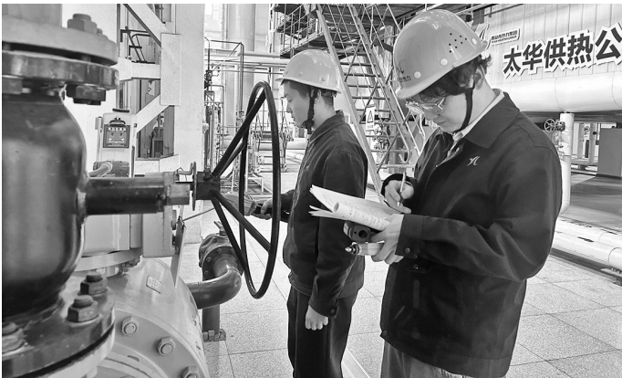
工作人员强化设备日常巡检。
